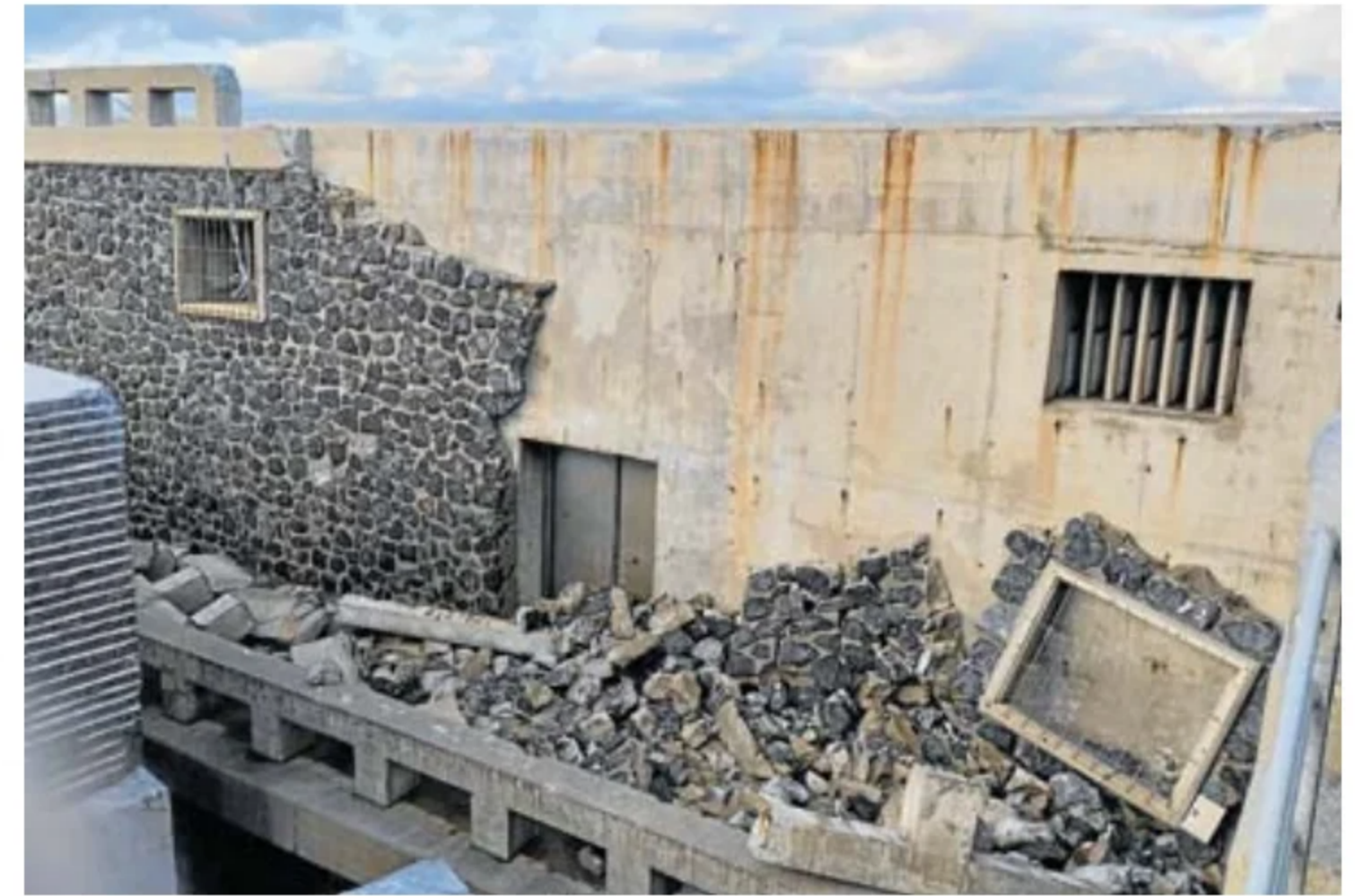
Daños ocasionados por las olas en la barandilla superior del dique y en el murete sobre el que se sustenta. DV
