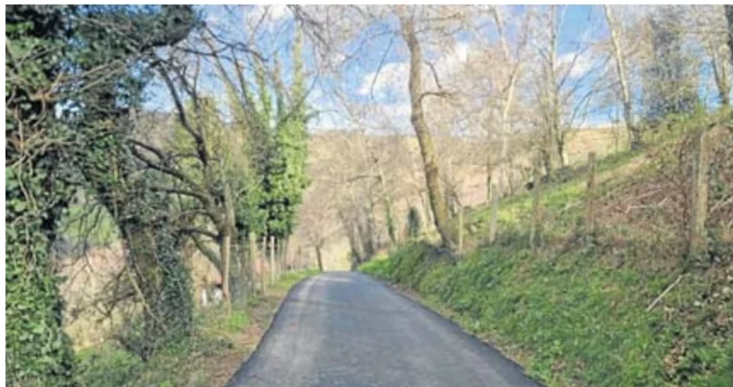
Vista del camino que lleva al caserío Aozar, situado en el barrio Sallobente-Ermuarian, ya reparado. DV
