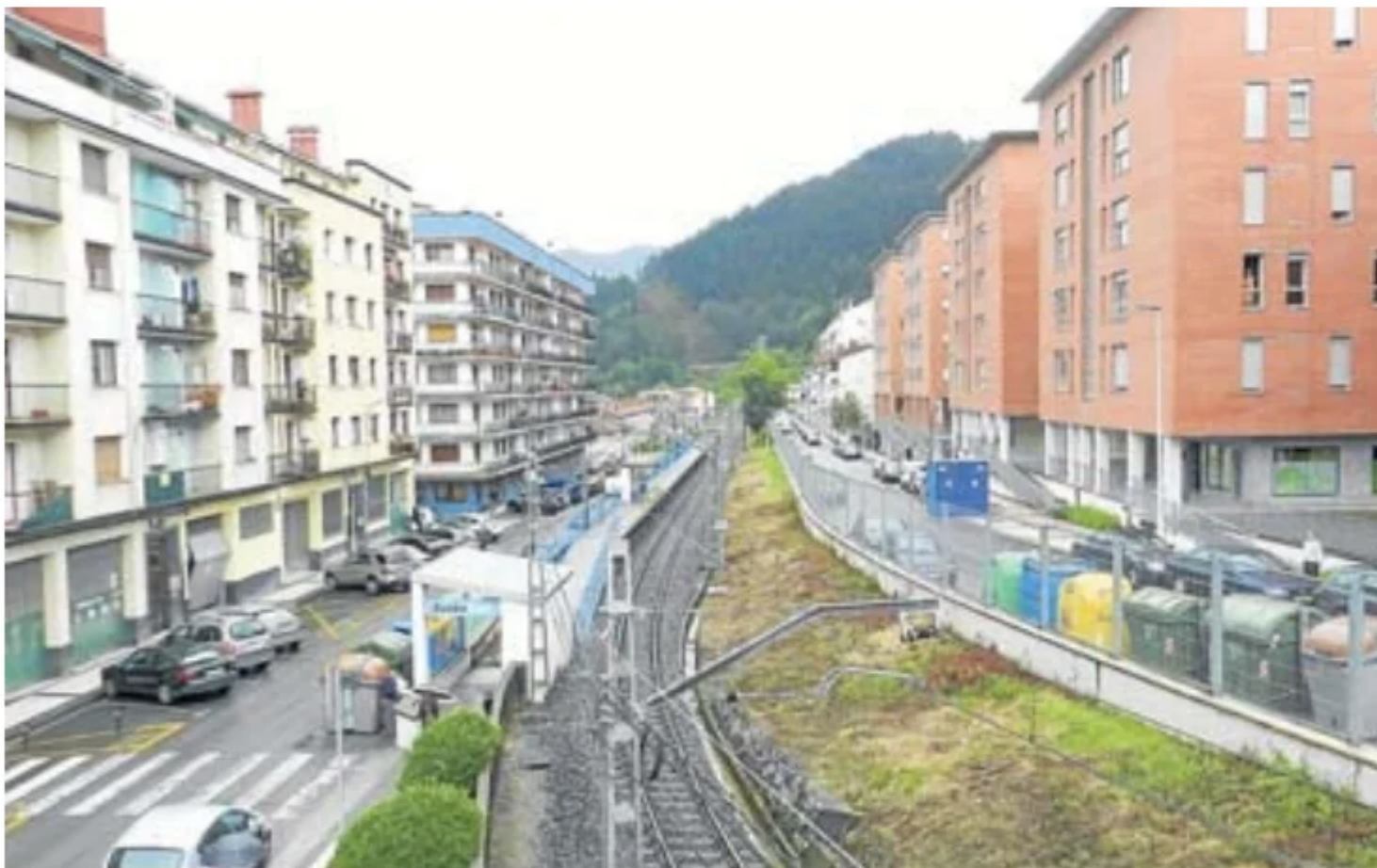
Vista del apeadero de Toletxe, donde han empezado los trabajos nocturnos para renovar las vías. DV
