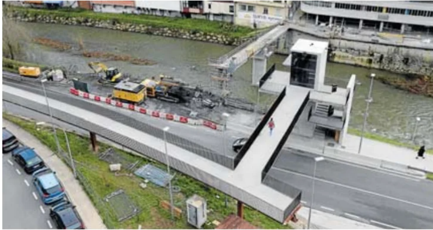
Las cuentas para 2025 destinan 643.541 para seguir con la renovación integral del puente de Urazandi. J. LEON
