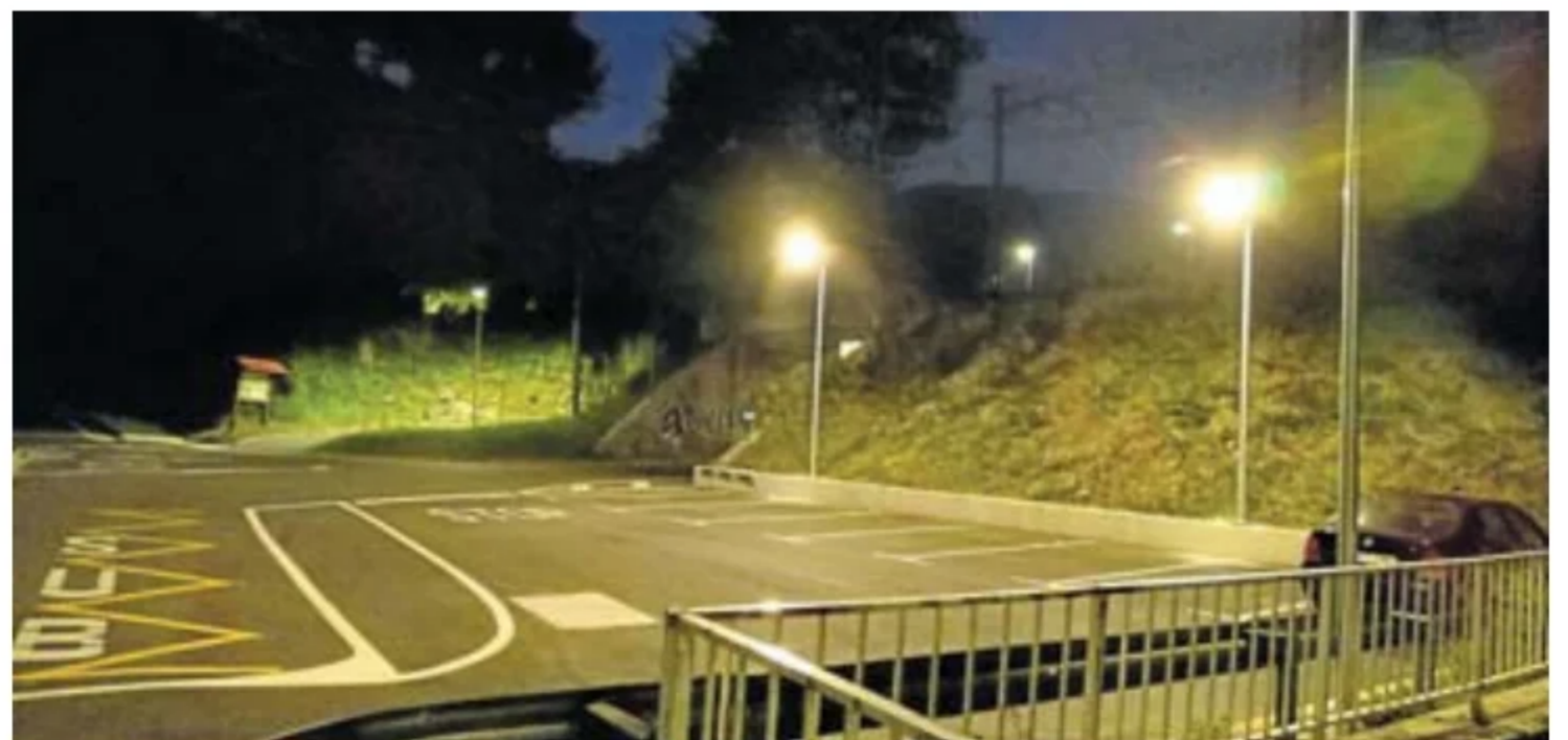
Las farolas solares instaladas en el aparcamiento de Arriaga, en funcionamiento. DV
